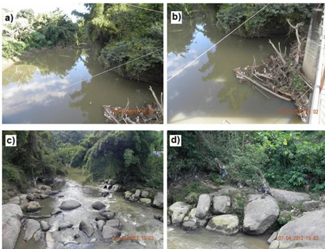
Figura 55: a) Visão de montante do ponto P27; b) Foto do tronco de árvore preso no pilar da ponte impedindo a passagem da água; c) Foto de jusante do ponto P27; d) Foto do lixo encontrado nas marcas de cheia.
